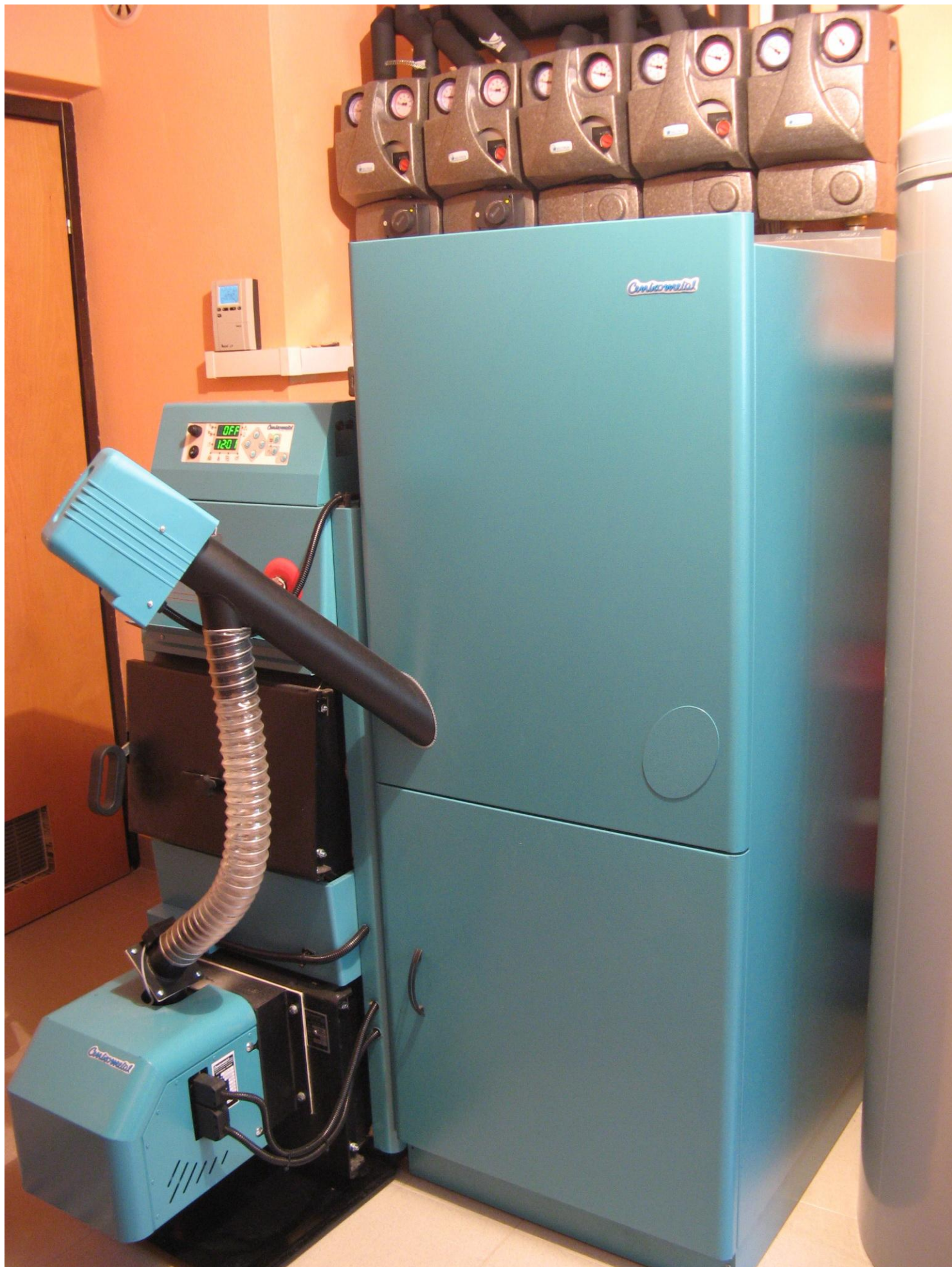
KOTLOVNICA: KOTEL NA PELETE CENTROMETAL EKO-CK P 30 + PELET SET, ZALOGOVNIK, TOPLOTNA ČRPALKA
