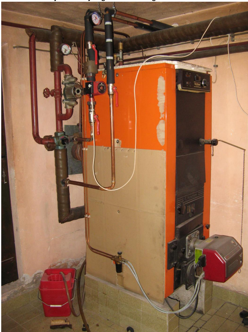
Pred menjavo obstoječega kombiniranega kotla:
